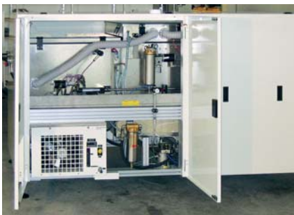
Gute Zugänglichkeit der Anlage bei Wartungsarbeiten
